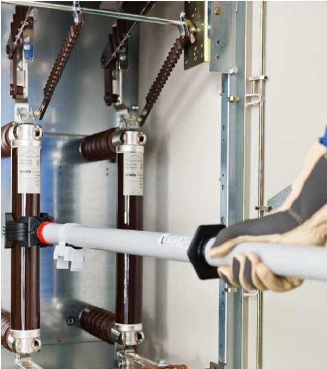
Bild 5-9: Wechsel einer HH-Sicherung mit vorschriftsmäßiger Sicherungszange
