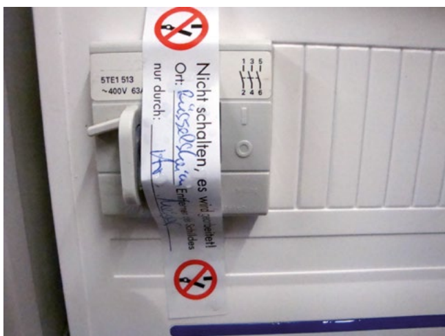
Bild 5-11: Gegen Wiedereinschalten gesicherter Hauptschalter
